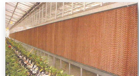
Fan & Pad system
